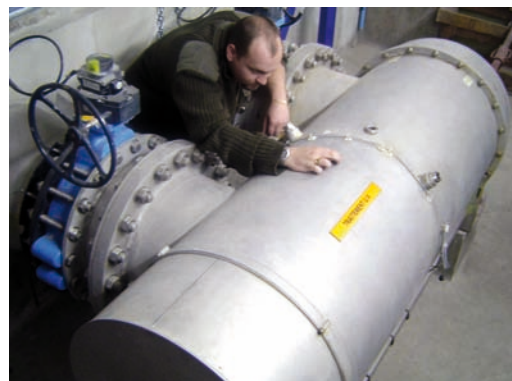
Commune de SETE, Installation BIO-UV pour la Potabilisation, Chantier réalisé par OTV France Sud.
