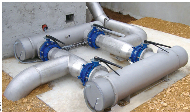
Commune de Gignac - Installation BIO-UV pour le traitement des eaux usées.
